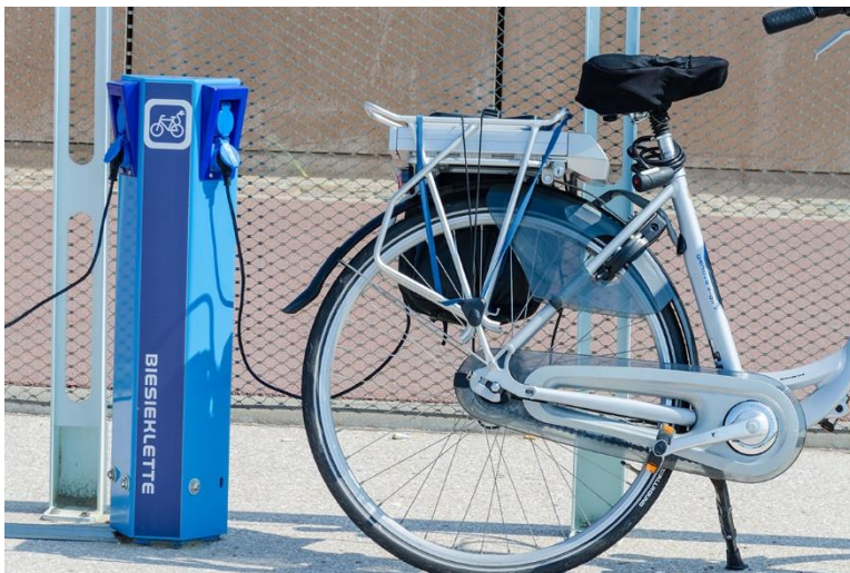
Laadpaal elektrische fiets
